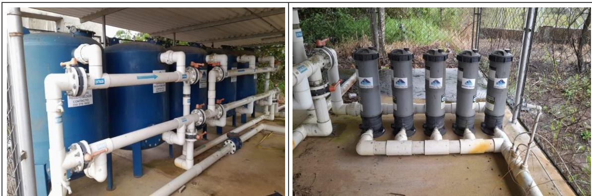
Imagen 2 y 3: Cinco (5) Filtros y Cinco (5) Microfiltros de potabilización.
